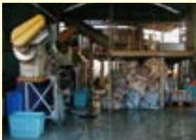
破碎洗浄機と処理前廃紙バック
